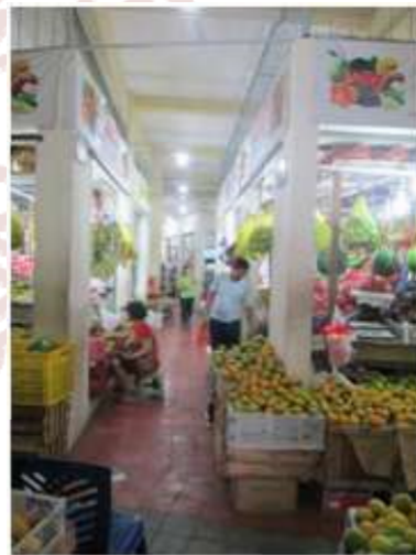
Gambar 27. Ceiling memanfaatkan duct lantai atas, kurang fleksibel apabila ada penambahan fixture di ceiling, nampak beberapa kabel listrik liar melintas antar kios
